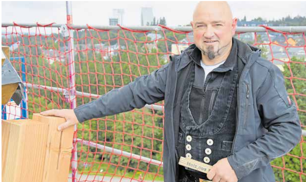
Zimmermeister Sandro Neubauer auf dem Gerüst in der fünften Etage des neuen Hotels.
