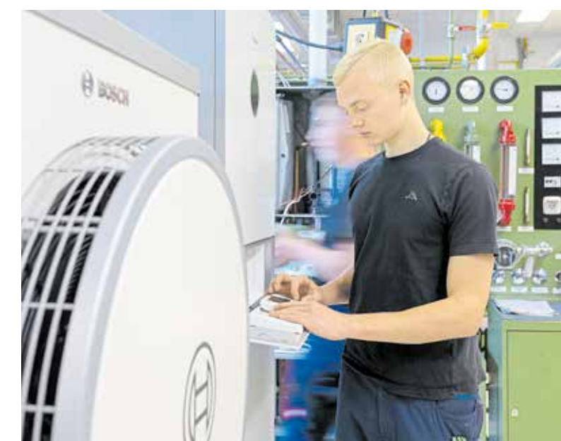
Von den Zuwendungen profitiert unter anderem auch der Fachbereich Sanitär-, Heizungs- und Klimatechnik im BTZ Rohr-Kloster. Foto: HWK Südthüringen/Michael Reichel
